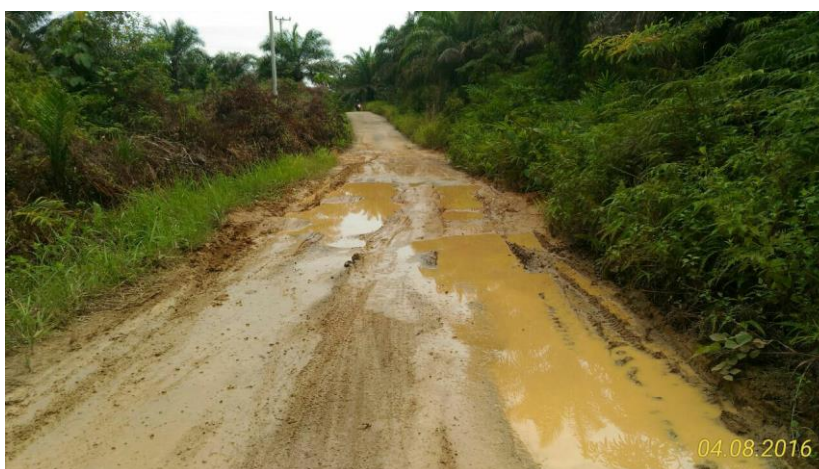
Gambar 18. Akses menuju salah satu RT setelah hujan
